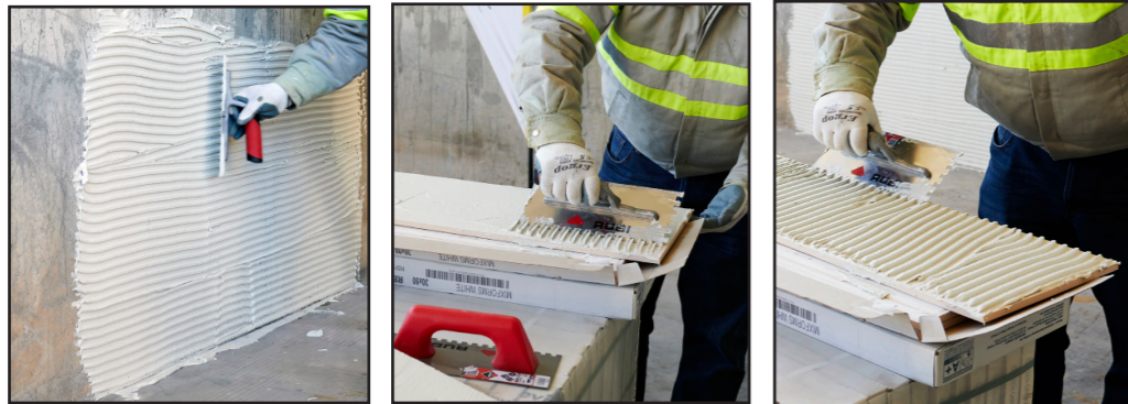
Fig. 21/22/23 Étaler le ciment-colle sur des petites surfaces (maximum 1m 2 ) sur le support, en une couche fine et serrée, pour l'hydrofugation de celui-ci, à l'aide d'une truelle dentelée.
