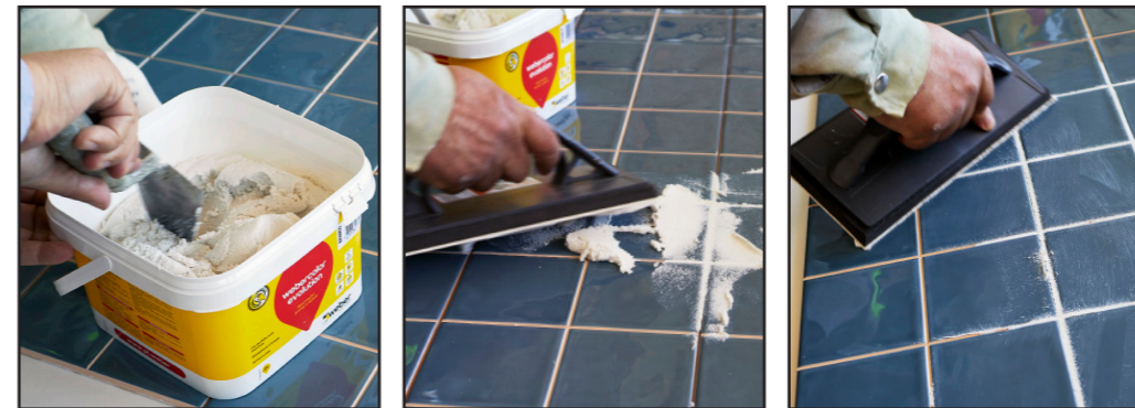
Fig.36/37/38 Le mortier doit être appliqué à l'aide d'une truelle en caoutchouc, en diagonale par rapport au sens des joints. Assurez-vous que le mortier est appliqué uniformément sur les joints afin d'augmenter leur durée de vie.
