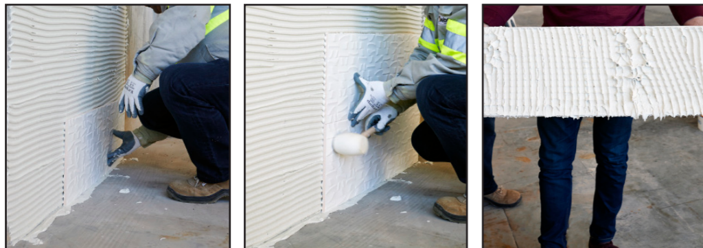
Fig.24 Ensuite, pressez le carreau contre le support afin d'écraser les sillons de ciment-colle, en veillant à ce que toute la surface soit remplie.
